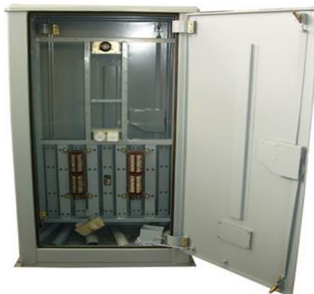
Рисунок 2 – Шкаф магистральной линии связи типа ШМС
